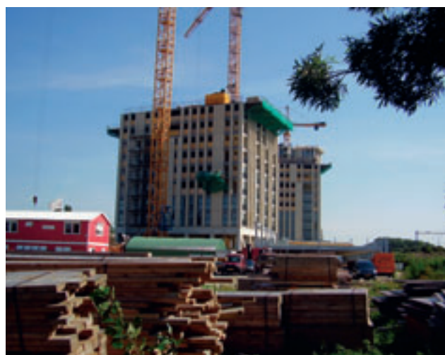
Het project Torens Waterweg in Maassluis is voorzien van duurzame verwarming en koeling.
